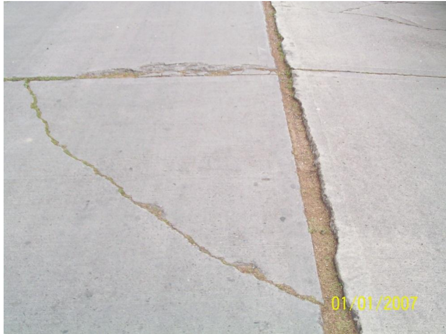
Fotografía 2. Grieta de esquina
